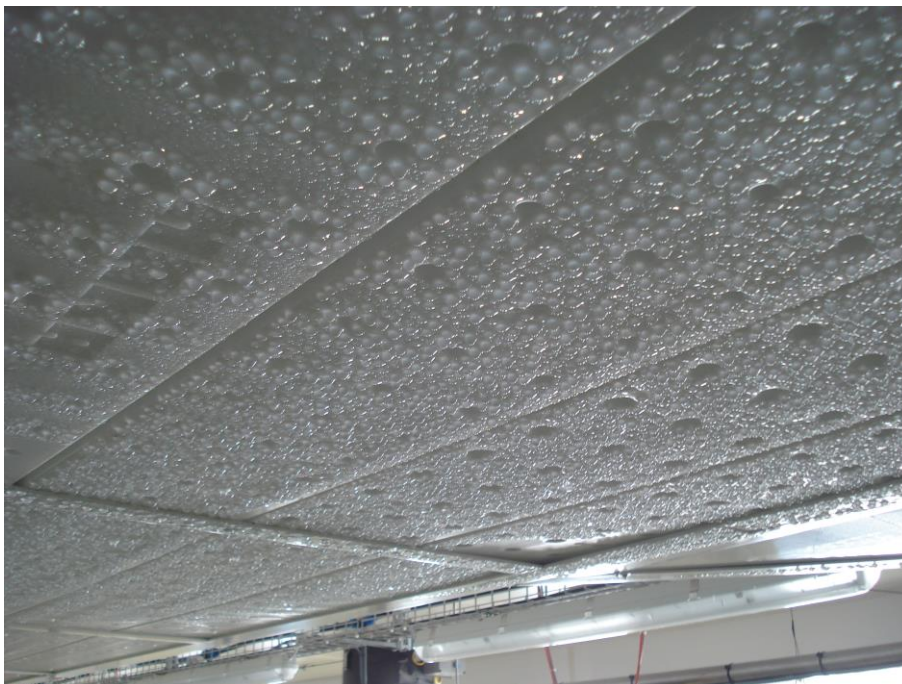
Nasse Decken bei zu hoher Luftfeuchtigkeit
