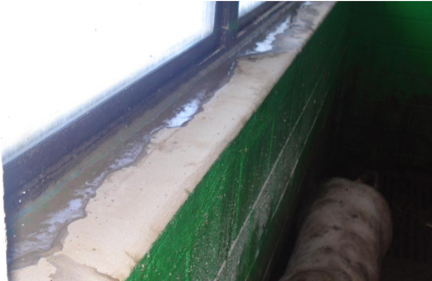
Nasse Fenster bei zu hoher Luftfeuchtigkeit
